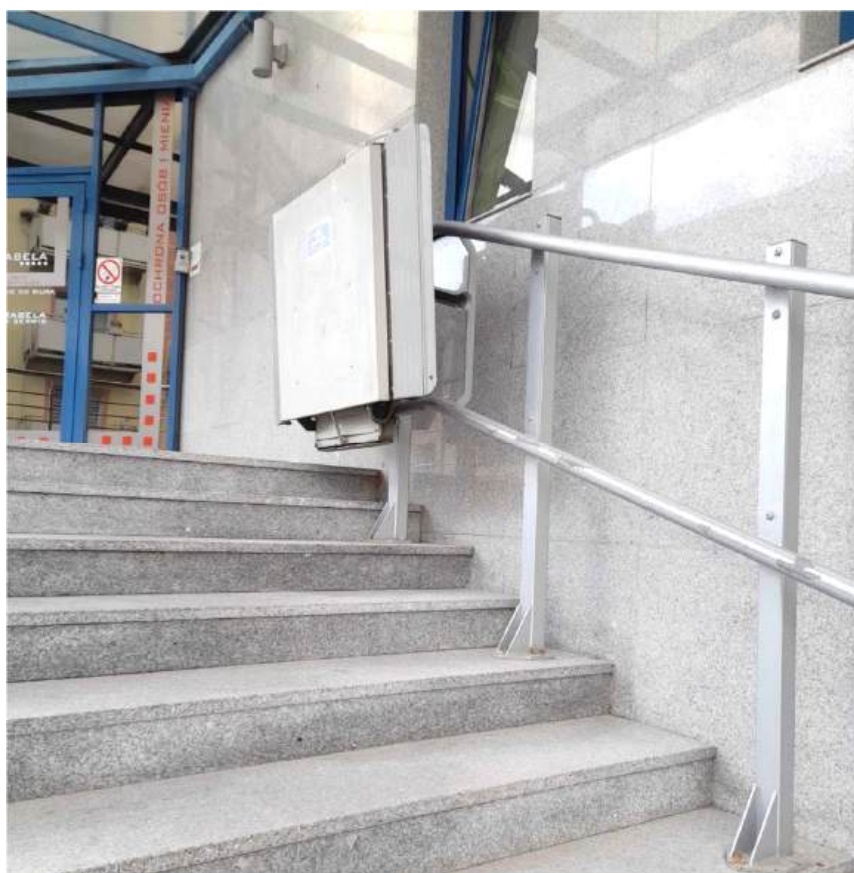
Rysunek 36. Winda dla wózków inwalidzkich zamontowana przed jednym z budynków w Rzeszowie
