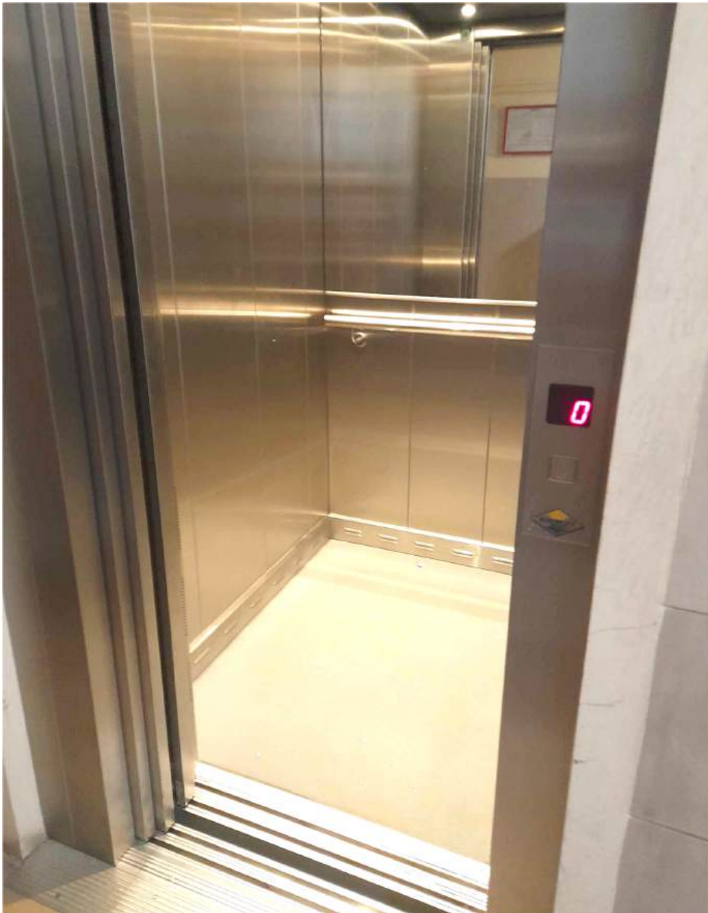
Rysunek 32. Winda dostosowana do potrzeb osób z niepełnosprawnością ruchową w jednym z bloków mieszkalnych w Rzeszowie
