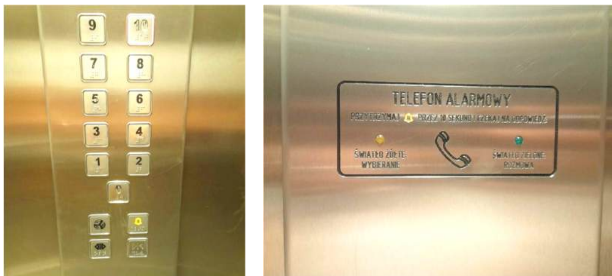
Rysunek 33. Panele zamontowane w windzie dostosowane do potrzeb osób z niepełnosprawnością wzrokową
