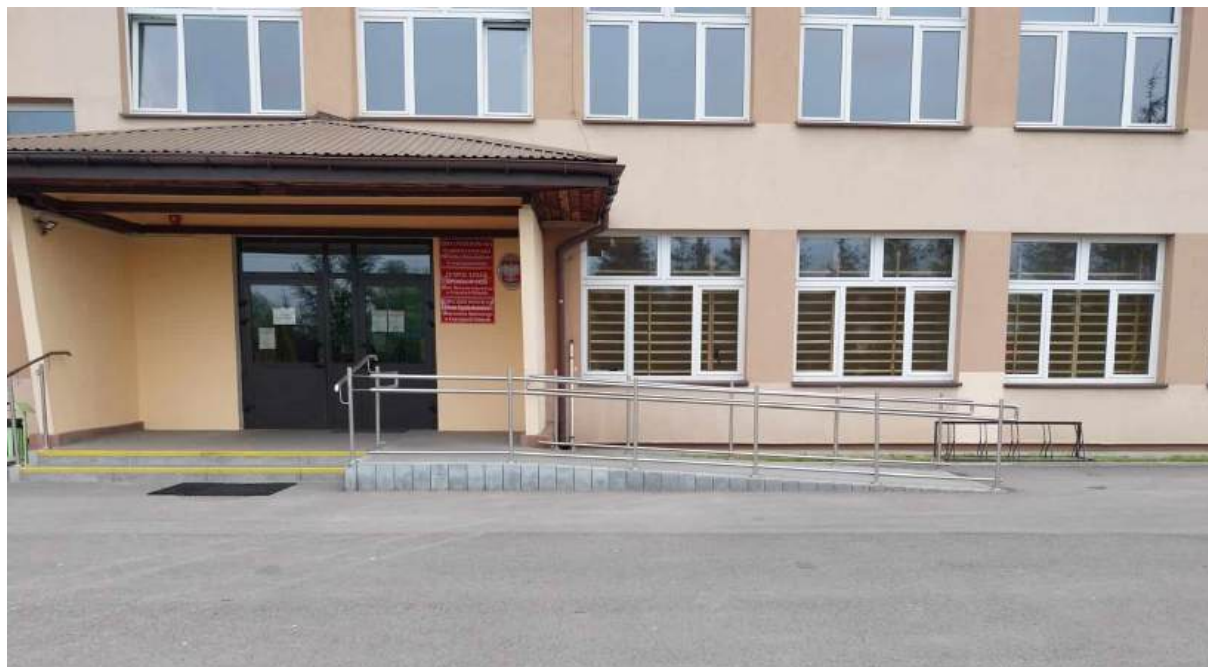
Rysunek 27. Nowa pochylnia dla osób z niepełnosprawnością ruchową zamontowana przy Szkole Podstawowej nr 2 im. Tadeusza Kościuszki w Ustrzykach Dolnych
