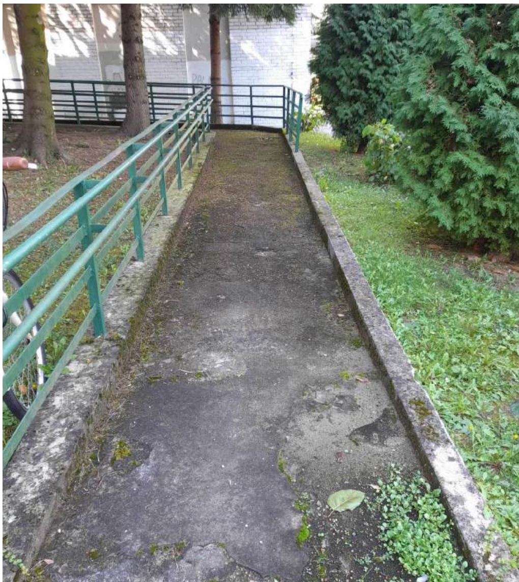
Rysunek 30. Pochylnia dla wózków inwalidzkich zamontowana przed jednym z bloków mieszkalnych w Rzeszowie
