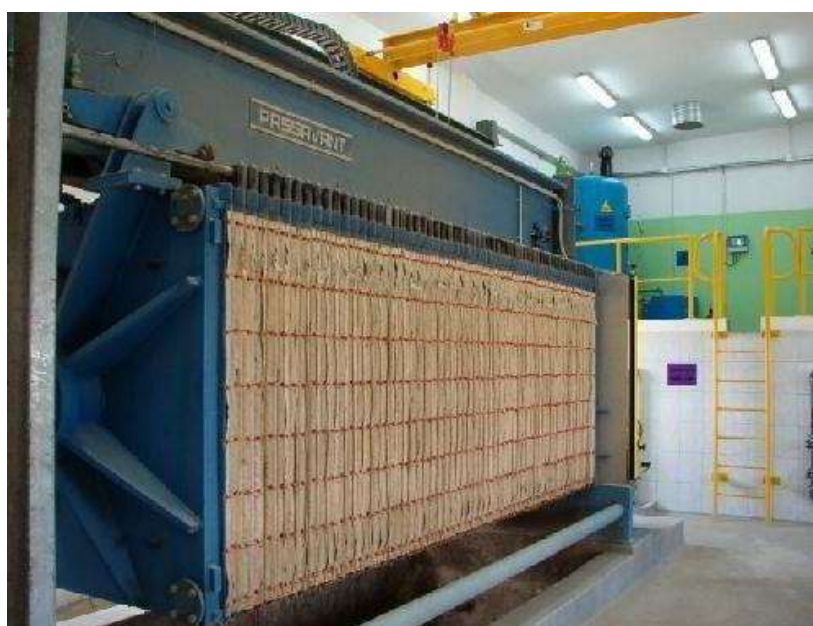
Rys. 18. Komorowa prasa filtracyjna osadów ściekowych oczyszczalnia w Chwałkowie [62].
