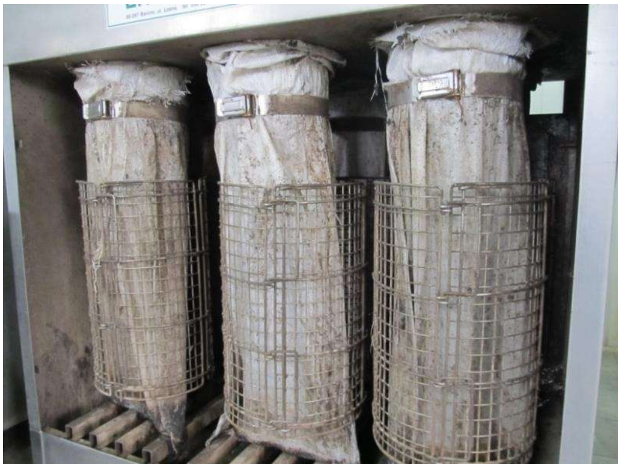
Rys. 20. Workownice odwadniające oczyszczalni ścieków w Grzebieńsku [19].
